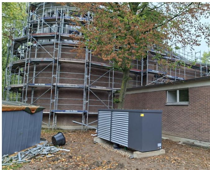
Wärmepumpe hinter der Sakristei
